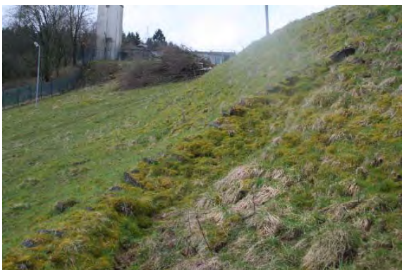
Bild 5: stark vermooste Steinrinne
