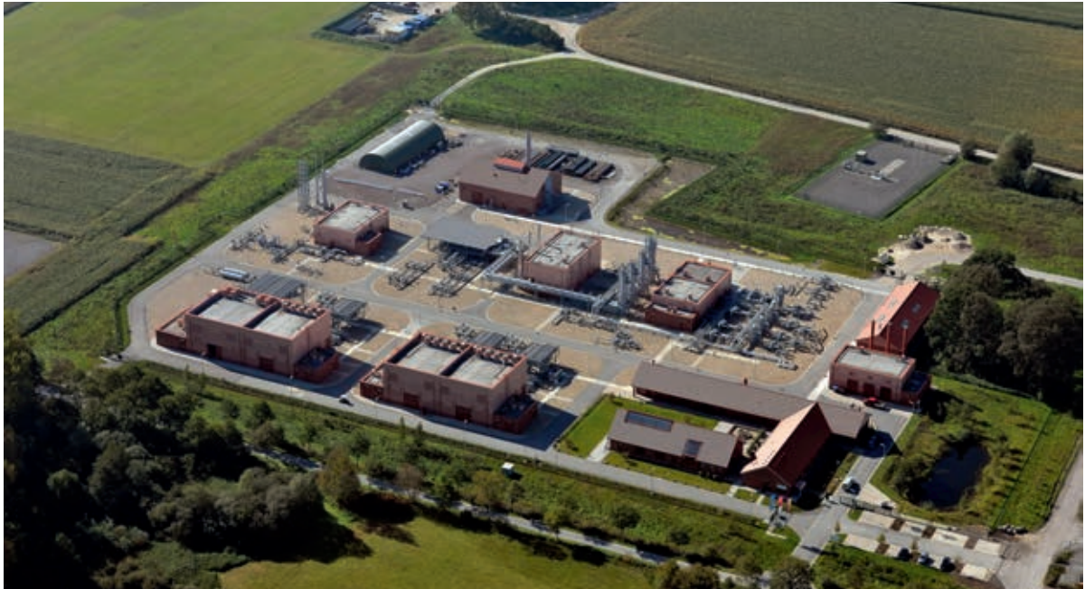
Abbildung 1: Die Verdichter- und Entnahmestation der Trianel in Epe aus der Vogelperspektive
